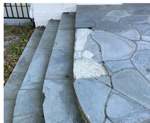
Skader på trappeanlegg
