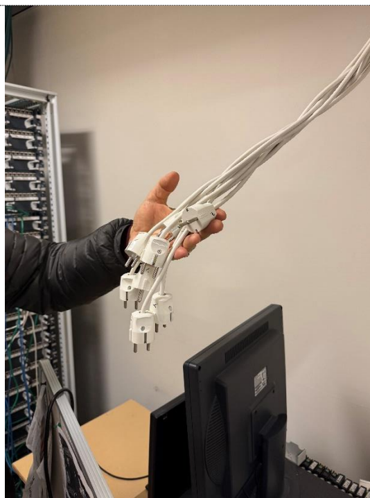
51 Løse ledninger på EL-rom
