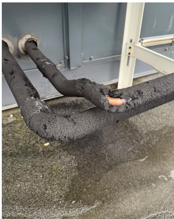
36 Luftbehandling. Isolasjon rundt rør.
