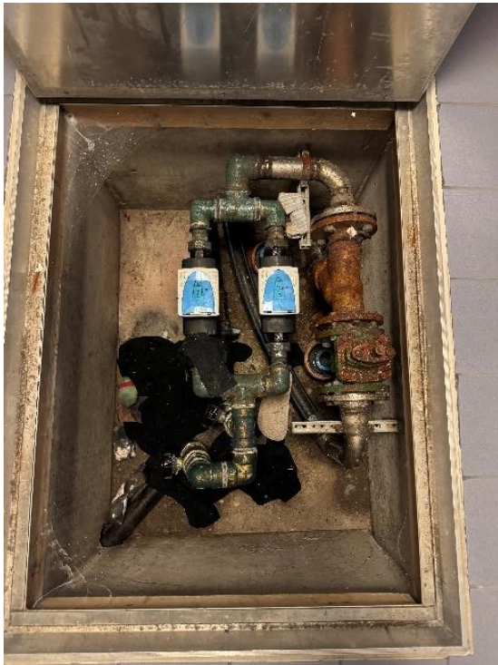
31 Sanitær. Stoppekran for skole, med en enkel luke over.
