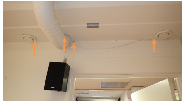
Foto 4. i korridoren: Over døren mot venterommet er asbestplaten perforert flere steder (piler), og hullene er ikke forseglet.
