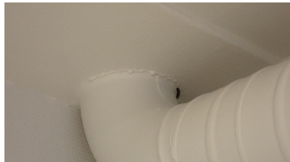
Foto 6. På undersøkelsesrommet: Åpningen for rørgjennomføringen er ikke tilstrekkelig forseglet.
