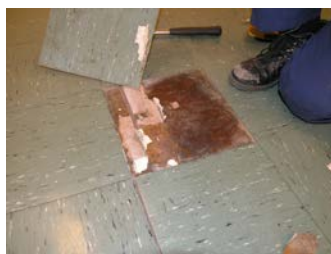
Gulvbelegg med asbest
