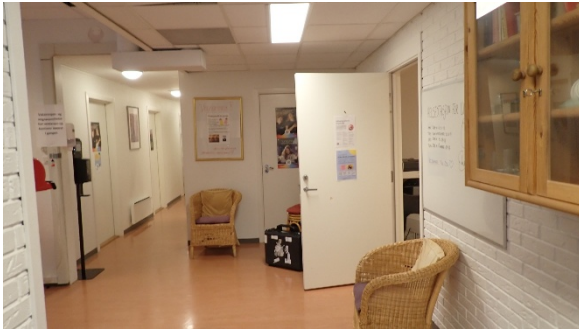
Foto 1. Venterommet. Den åpne døren er inn til korridoren med asbestplate i himlingen.
