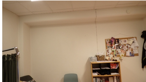
Foto 2. Kontoret: asbestplaten er ikke perforert for rørgjennomføringer, men en ledning er festet til platen. Hvordan ledningen er festet i platen er ikke nærmere undersøkt.
