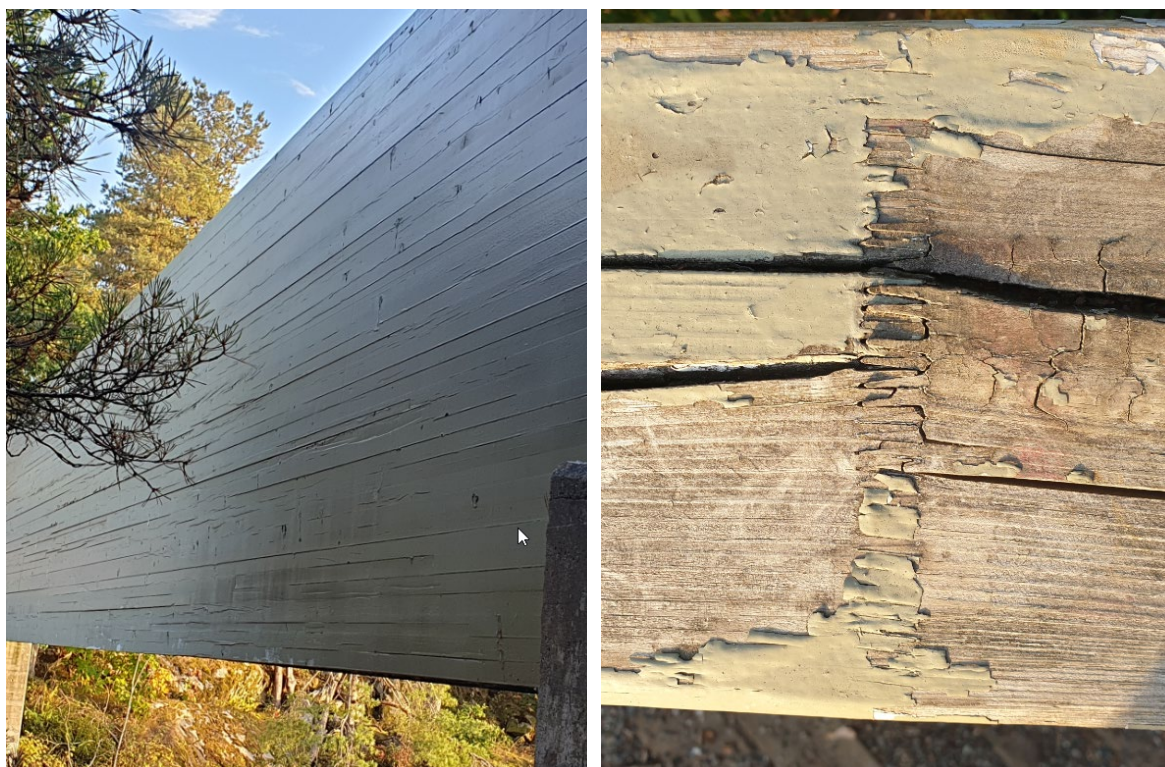
Figur 6: Tydelig oppsprekking mellom lameller. Til venstre ses østre bjelke fra siden. Bilde til høyre er tatt ovenfra og ned mot oversiden av limtrebjelke ved en fingerskjøt.
