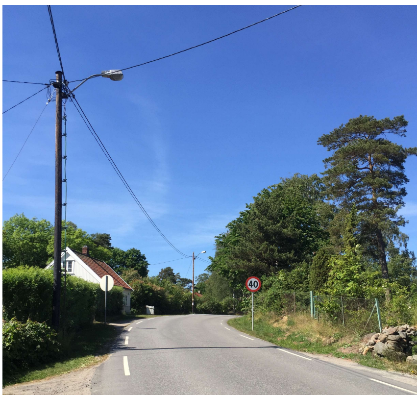
Figur 15 Belysningsmaster med tilhørende luftstrekk langs fylkesvei 119.
