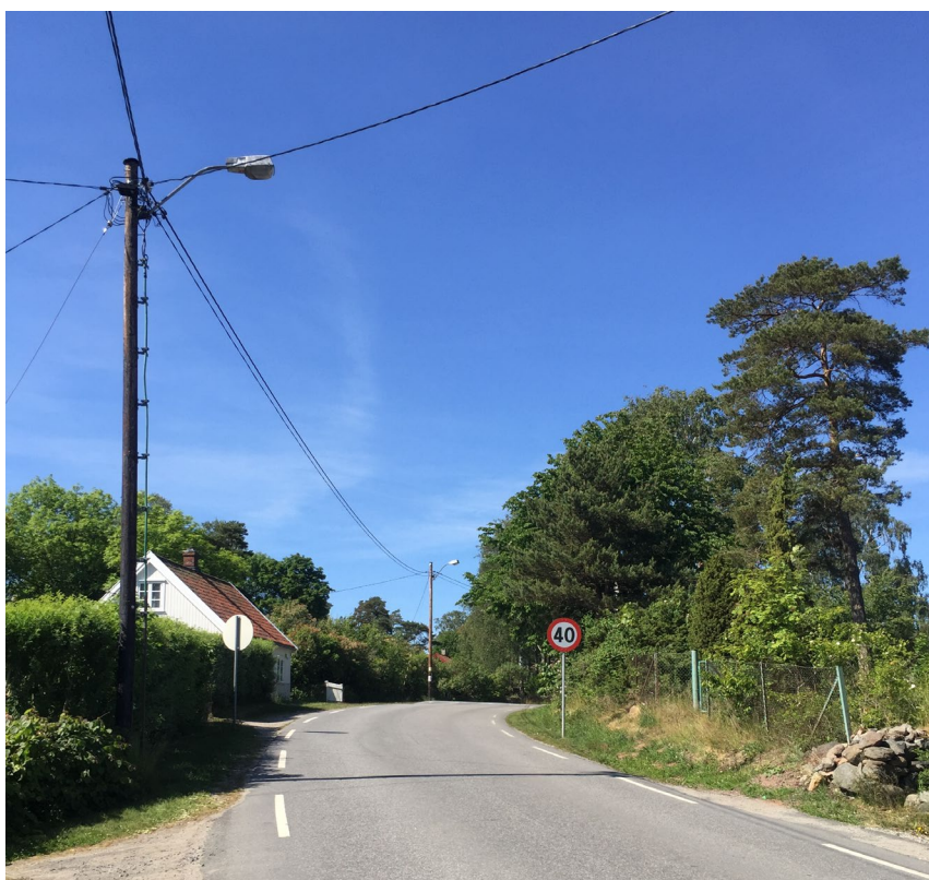
Figur 15 Belysningsmaster med tilhørende luftstrekk langs fylkesvei 119.
